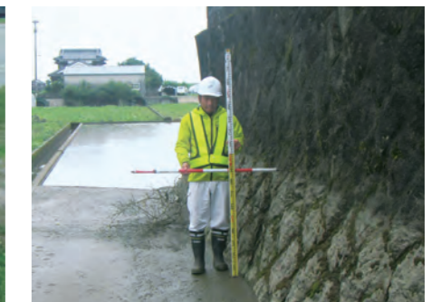
浸水状況調査
